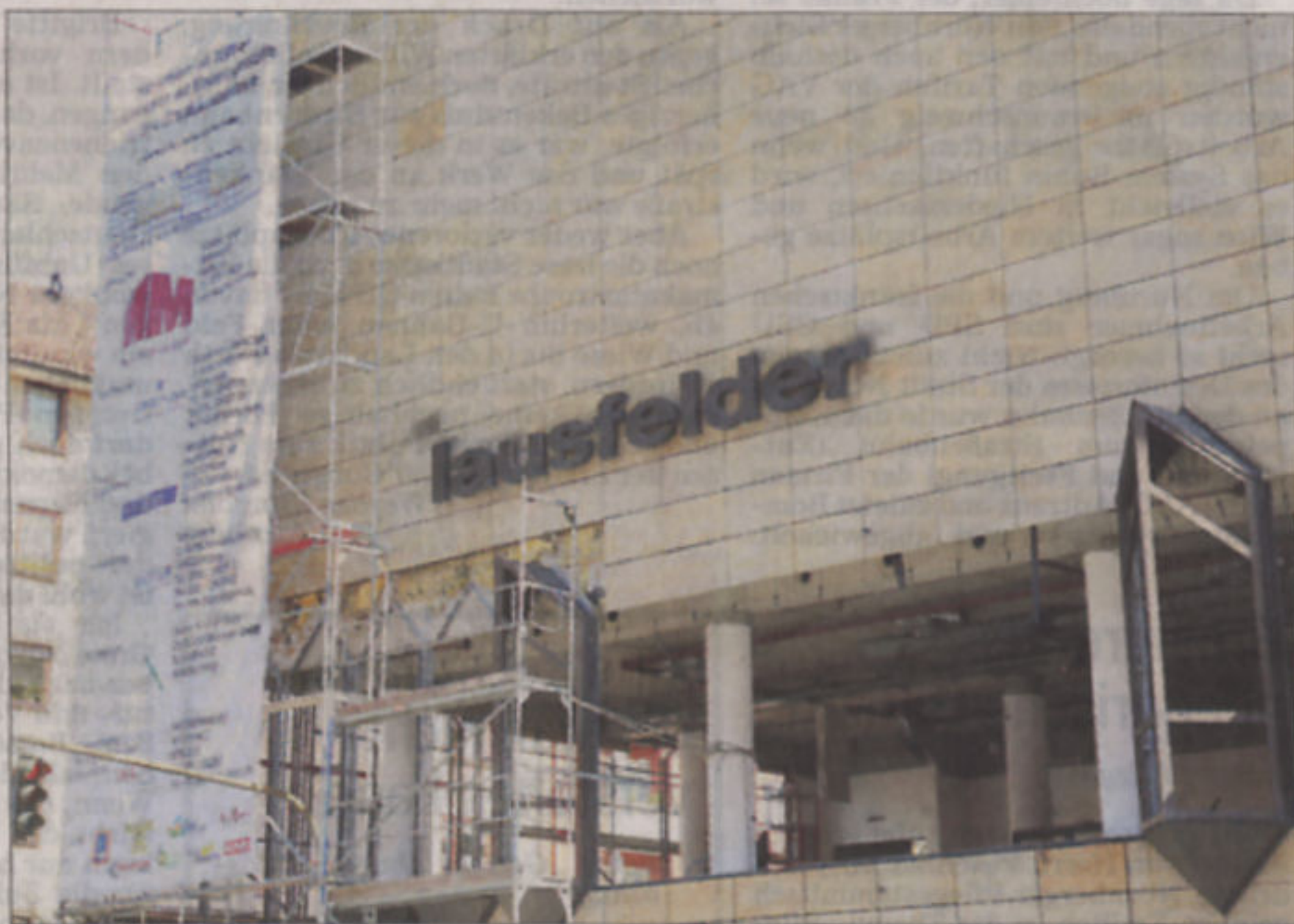
Nur noch ein paar Fassadenreste und der Schriftzug „Klausfelder“ erinnern an das alte Kaufhaus an der Sandstraße, das gegenwärtig abgerissen wird. Foto: Fengler
